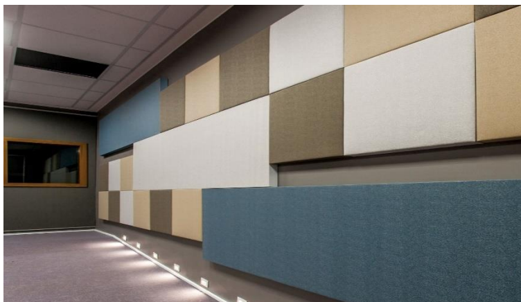
Figura 62 Revestimiento acústico panel absorbente modular Fuente: Arqmat 2023.
