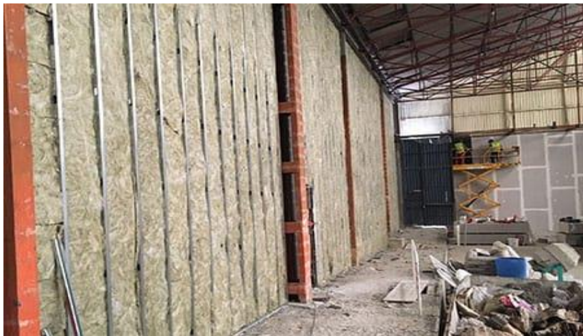
Foto de acondicionamiento acústico en muro tomada de (Acústica E. , 2019)
