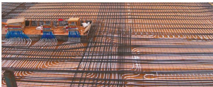
Ilustración 76. Tuberías TABS en la estructura de la edificación Tomado de: (Fundación de la Energía de la Comunidad de Madrid y la Consejería de Economía y Hacienda Comunidad de Madrid, 2014)
